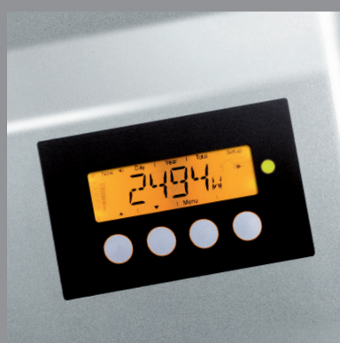
Über das Display können Sie auf alle wesentlichen Daten der PV-Anlage zugreifen
