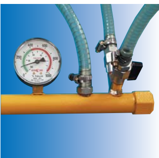
Verteilerleitung mit Kontrollvakuummeter im Sichtbereich.
