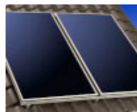
Fertig montierte Kollektorfläche
